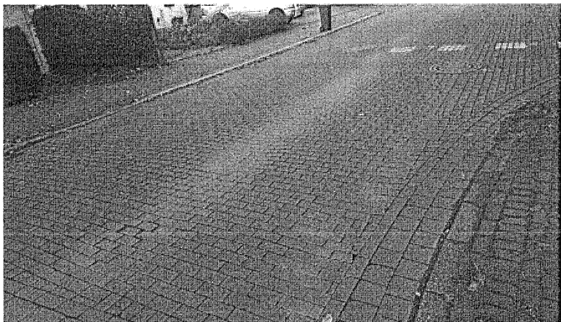
Lärmverursachende defekte Aufpflasterung Reiherstraße / Sperberweg mit Spurrillen
